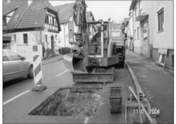
Wasserrohrbruch in der Schillerstraße
